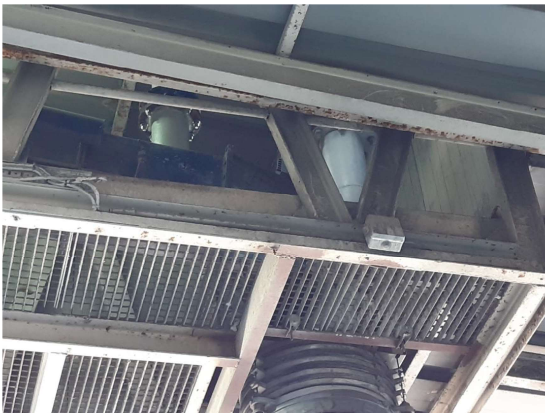
Sistema de descarga a los camiones
