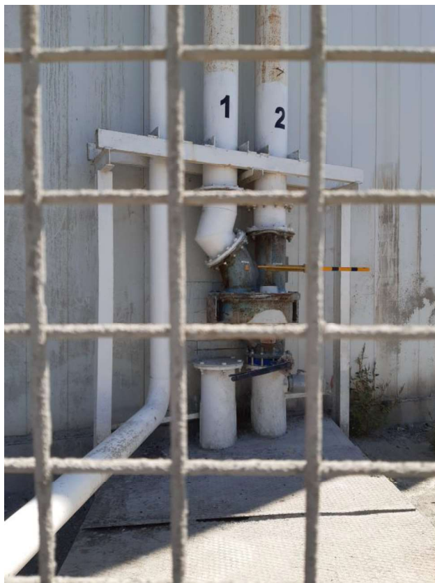
Llegada del tubo de carga al silo
